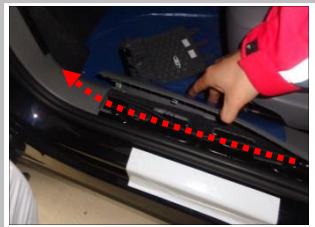
3.6 正极走线，顺着脚踏板到 A 柱
