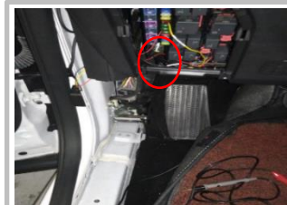
3.7 正极走线，顺着脚踏板到 A 柱
